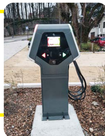
Une nouvelle borne de recharge sur le parking du Champ de foire ►
